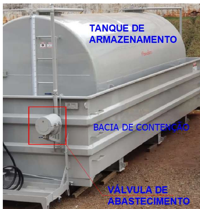
Figura 15 - Ponto de Abastecimento dos Tanques
