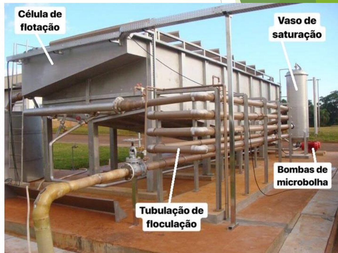
Tubulação de floculação (floculador hidráulico)
