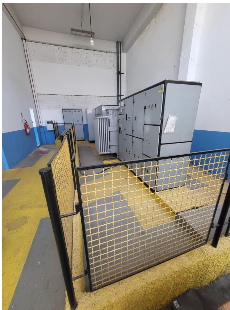
Figura 25. Subestação de energia do Porto de Laguna.
