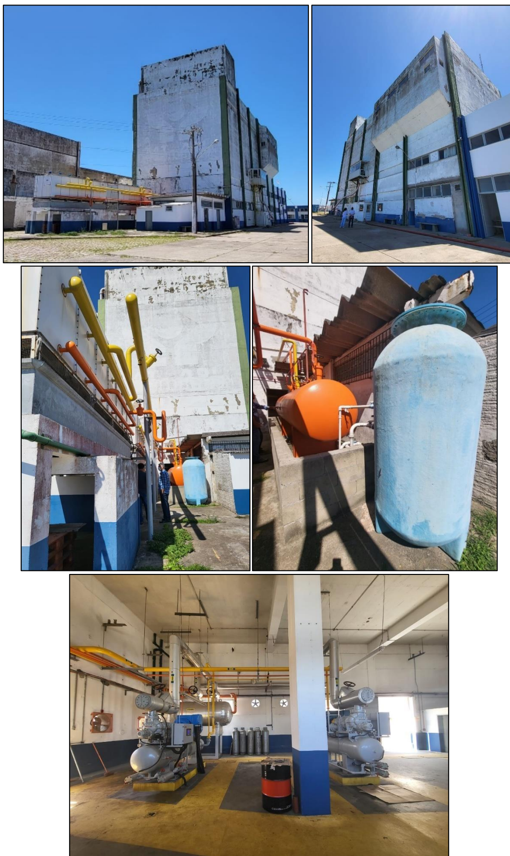
Figura 24. Instalações da fábrica de gelo que opera no Porto de Laguna.
