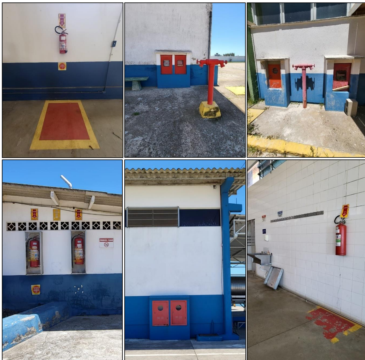
Figura 27. Exemplo de equipamento de combate a incêndio instalado no terminal.
