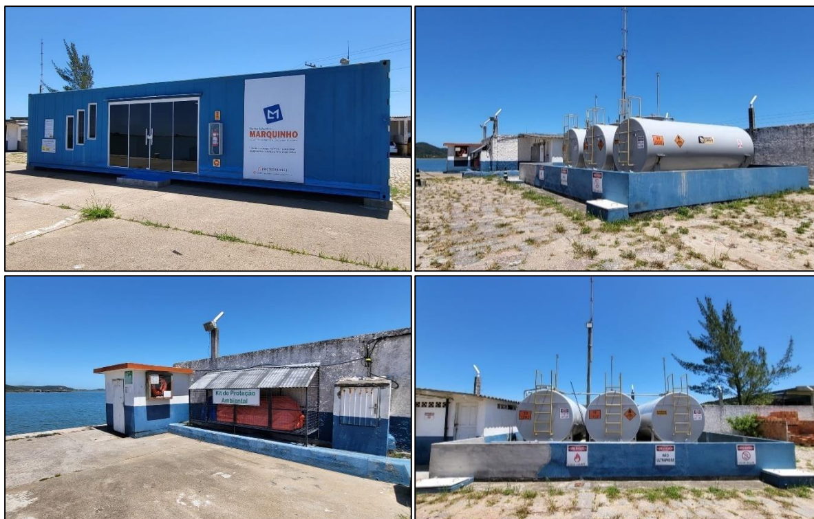
Figura 23. Instalações do posto de combustível que opera no Porto de Laguna.
