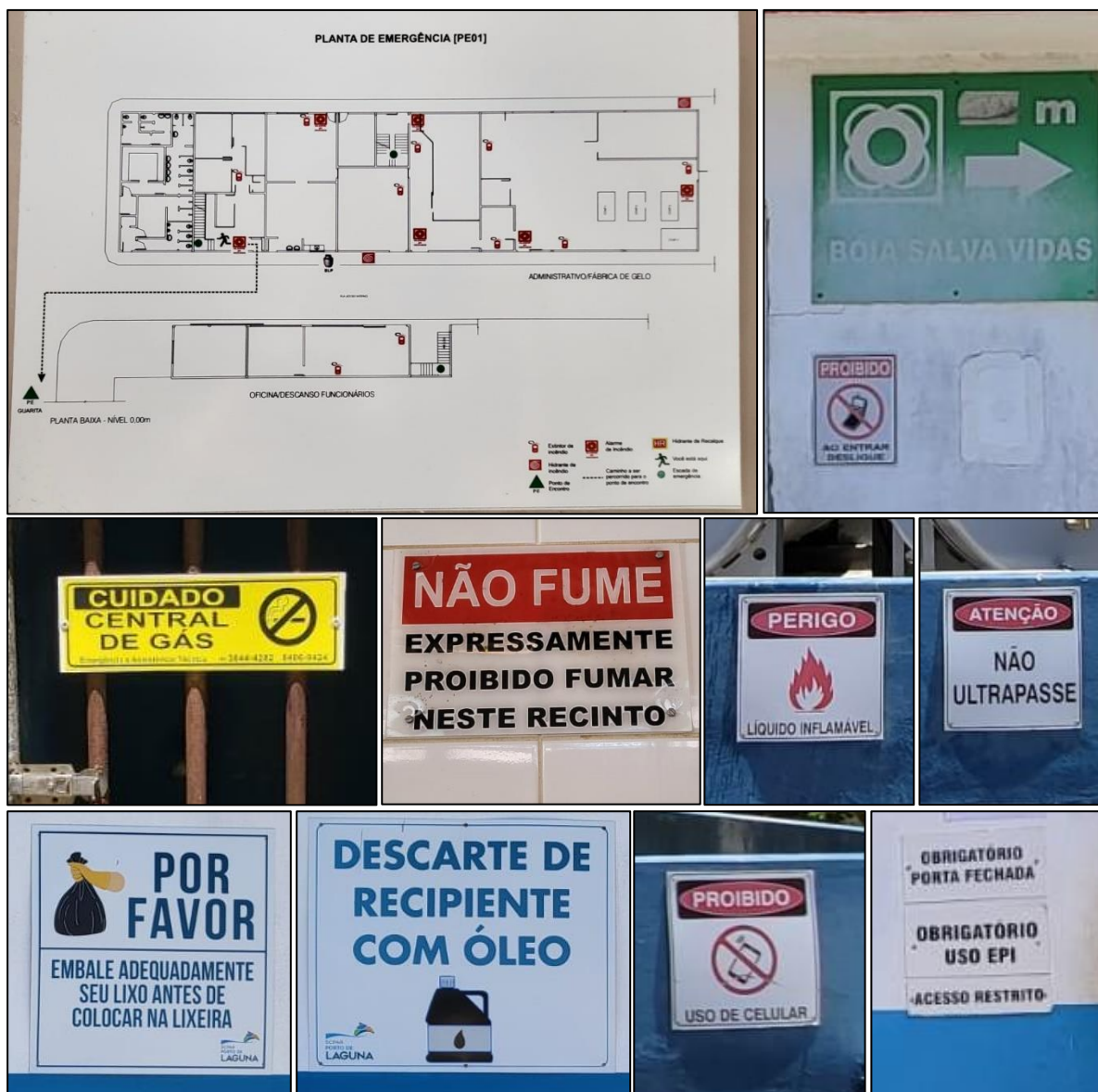
Figura 29. Exemplo de sinalização instalada no terminal.
